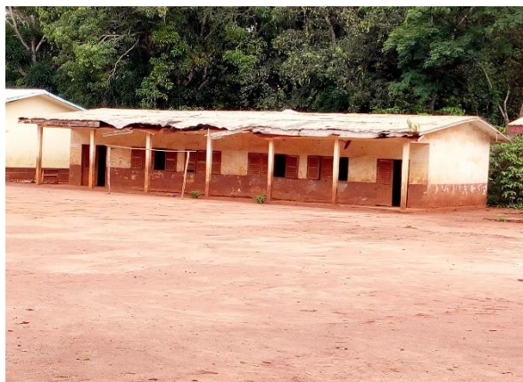
Photo 18 : vue d'un bloc des salles délabrées de l'EPP de Ngandamé
