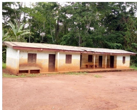
Photo 22 : vue du bâtiment délabré du CSI de Ngandamé
