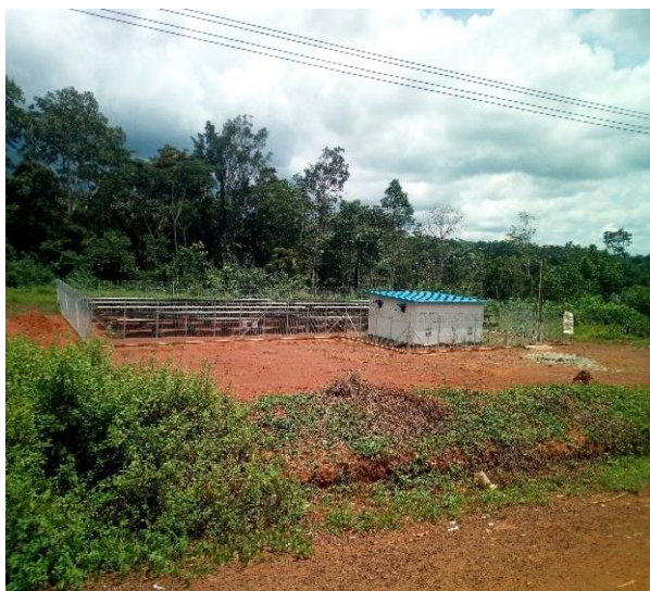
Photo 27 : vue du champ des plaques solaires de Ngomdouma
