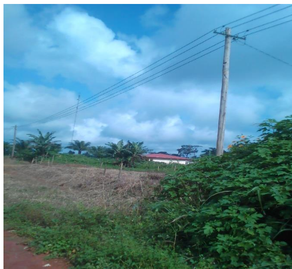
Photo 28 : vue du réseau électrique de la ville de Doumaintang
