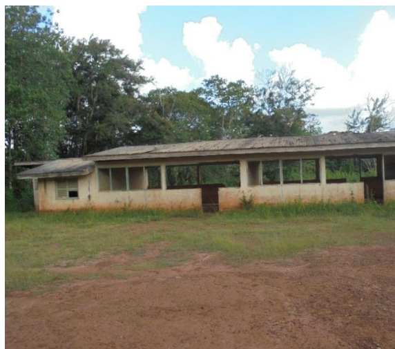
Photo 6 : mauvais état des Bâtiments de l'EP de BELITA 2
