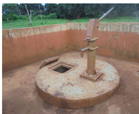
Photo 8 : puits aménagée en panne à Taparé
