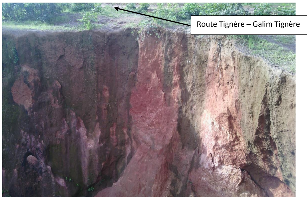
Photo 17. Fondrière de Lompta le long du tronçon Galim Tignère – Tignère.
