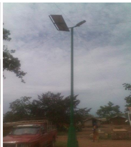
Photo 33 : Lampadaire solaire installé devant la chefferie de Lolo, Avril 2017
