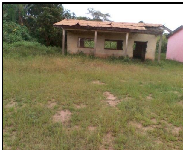
Photo 21 : Salle de classe en mauvais état de l'EPP de Sandji 1, Août 2017
