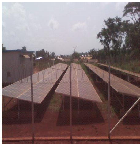
Photo 31 : Centrale d'énergie solaire pas encore opérationnelle de la ville de Kentzou, Avril 2017
