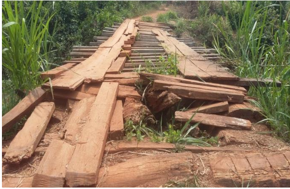
Photo 27 : Pont dégradé dans le village Djélélon,
