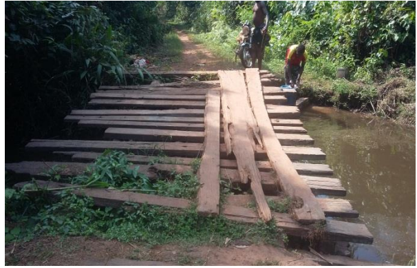
Photo 28 : Ponceau dégradé dans le village Gbambala
