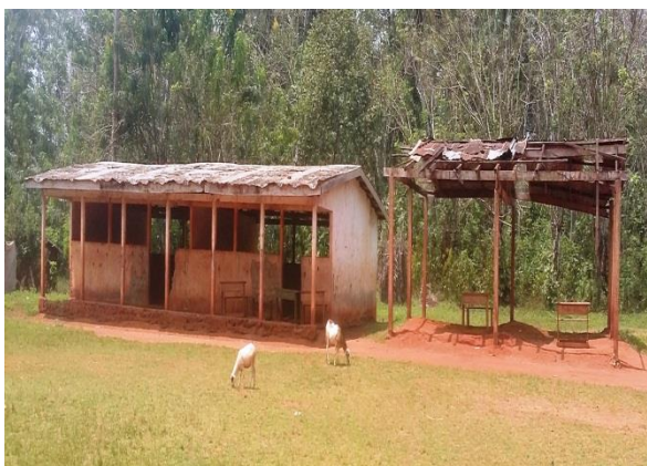
Photo 18 : Salle de classe en mauvais état de l'EPP de Bimba
