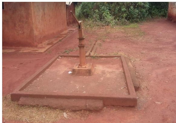
Photo 12 : Forage endommagé dans le Village Mbama
