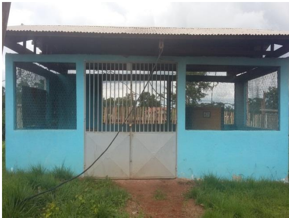
Photo 29 : Vue partielle du groupe électrogène communal
