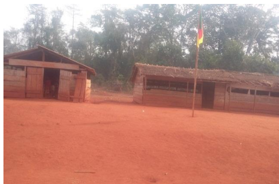
Photo 20 : Salle de classe en mauvais état de l'EPP de Mokoko
