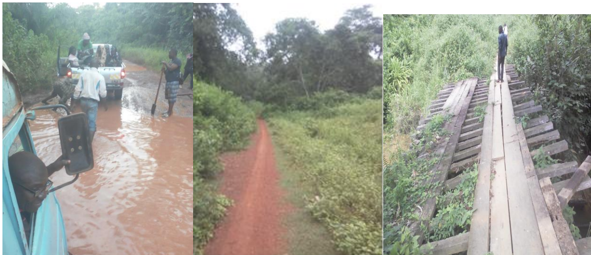
Photo 12 : A gauche un point critique à 3 km de Moloundou, au milieu, piste reliant Moloundou-Rivière à Ndongo et enfin à droite une vue du pont endommagé sur la rivière Evéh (Photos GIC ALUMNI DE L'EST, 2017)
