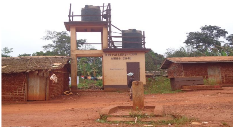
Photo 20: Etat de la mini adduction d'eau dans le village d'Ampel avec 04 bornes fontaines en panne.
