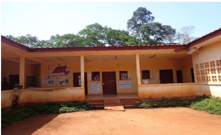
Photo 23: Etat des infrastructures du CSI de Medjoh dysfonctionnel
