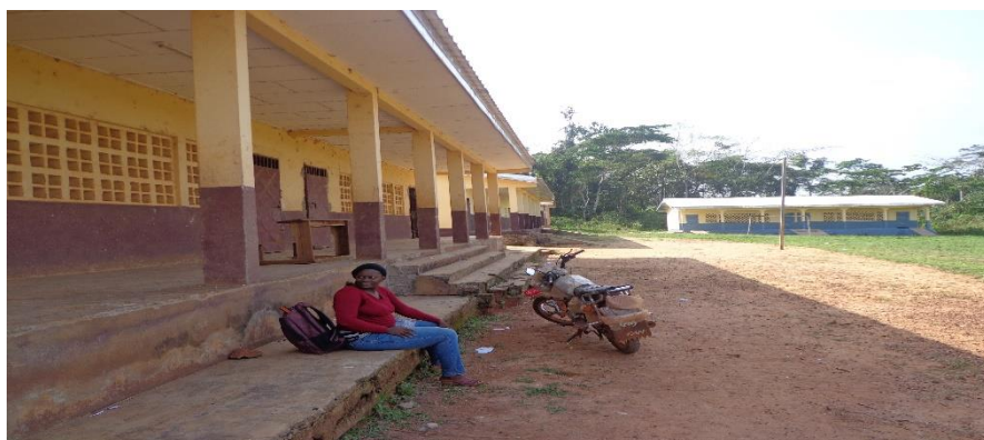
Photo 24: état des salles de classe de l'EPP de Djolempoum
