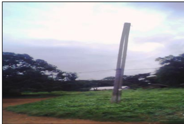
Photo 31 : Poteau électrique dans la ville de Ngoura, 2017
