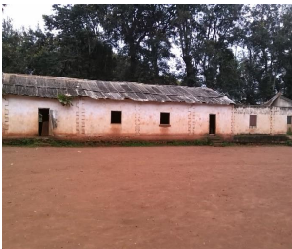
Photo 10: Vue partielle d'un bloc de salles de classe en mauvais état à l'école publique de Bengue Tiko
