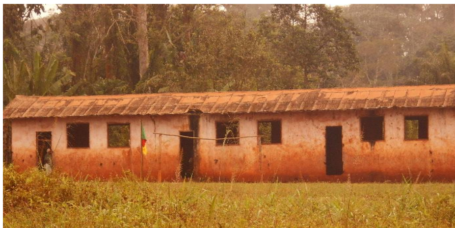
Photo 12 : Vue panoramique des salles de classes défectueuses à l'EPP de Salapoumbé
