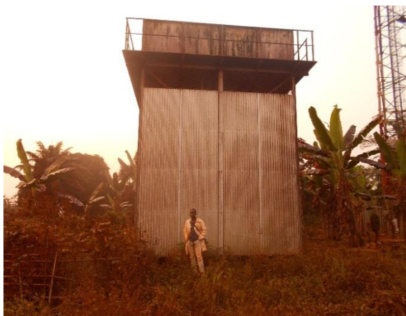
Photo 18 : Réseau d'adduction d'eau scan water de Salapoumbé non fonctionnel
