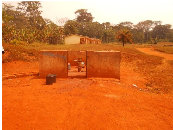
Photo 14 : Puits d'eau avec PMH au CETIC de Salapoumbé
