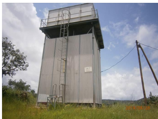
Photo 19. Château SCAN WATER de Tignère ville (x : 12,665212 et y : 7,37480996). Cliché Batchanou
