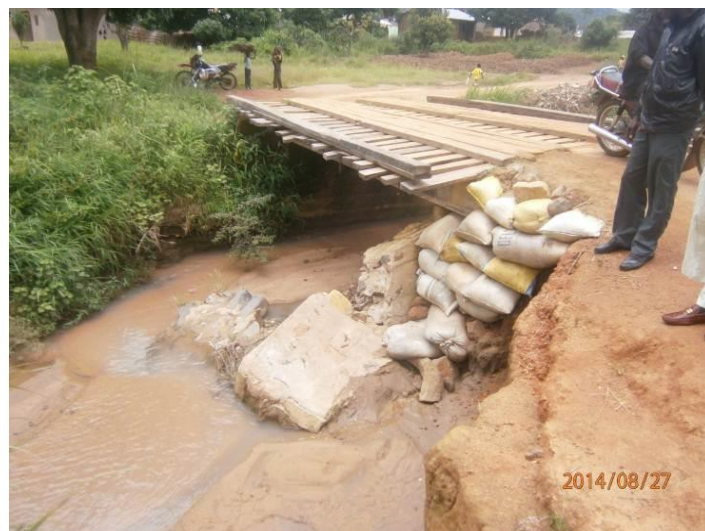
Photo 31. Pont en mauvais état, solutions endogènes appliquées (Quartier Mayo-Djarandji). Cliché Batchanou
