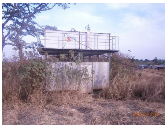
Photo 20. Château SCAN WATER de Doualaye (x : 12,7et y : 7,01). Cliché Batchanou
