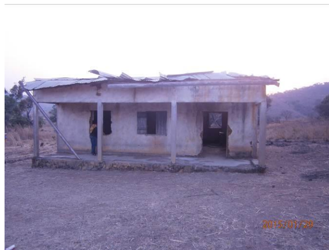
Photo 47. Bâtiment en mauvais état (EP Garbaya Kadjiri). Cliché Batchanou
