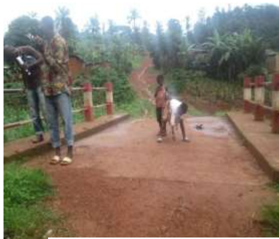
N° 2 : Un ponceau mal entretenu
