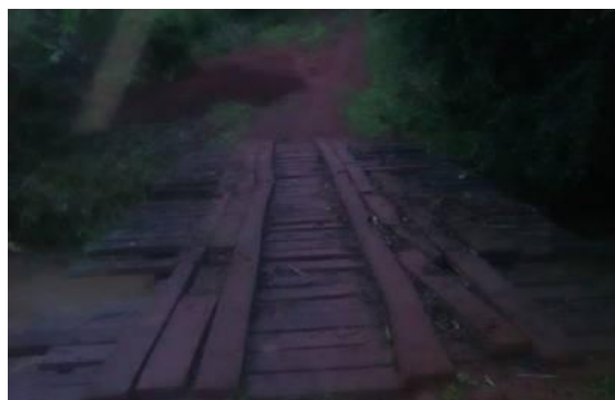
Photo 16: Pont en dégradation à Baloué
